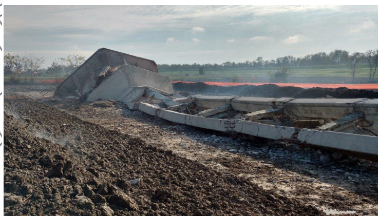
La torre piezo a terra nell'area di caduta
